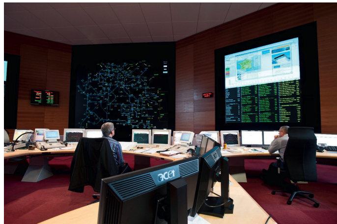
Sources : Media Center EDF-RTE, réseau Transport - Salle de dispatching, Centre National d'Exploitation du Système (CNES) à Saint Denis – Crédit Photo : SARGOS ALEXANDRE
